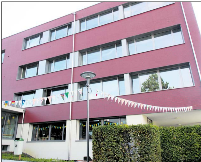
Einige Schäden an der Fassade, Folgen des Hagelwetters vom 28. Juni 2021, konnten bis heute nicht beseitigt werden.
